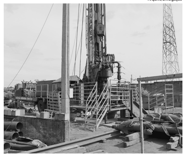
Poço profundo perfurado ao lado da ETA foi fundamental para aumentar a oferta de água em Bariri
